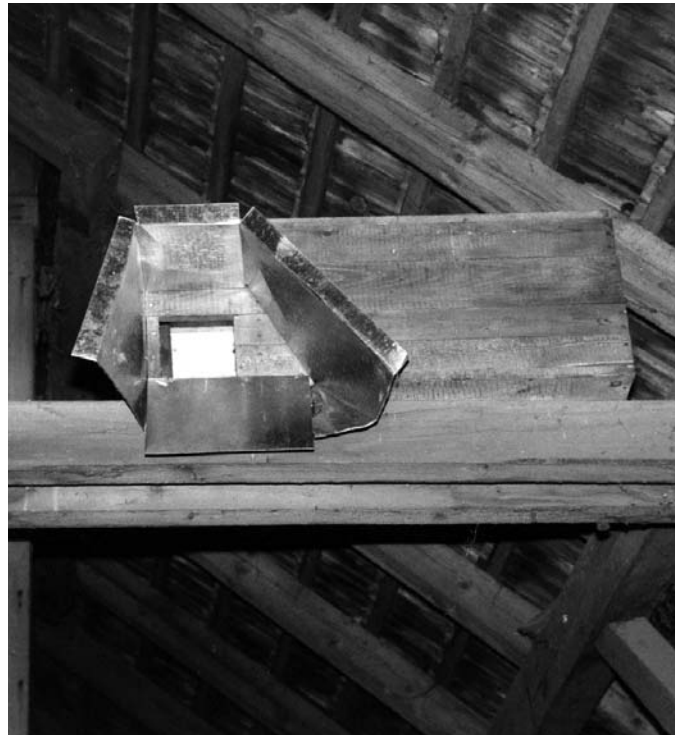
Detail zabezpečené budky pro sovu pálenou proti kuně, instalované na půdě kravína. I takto zabezpečenou budku sova pálená bez problémů obsazuje. Okres Znojmo, 16. 6. 1998
